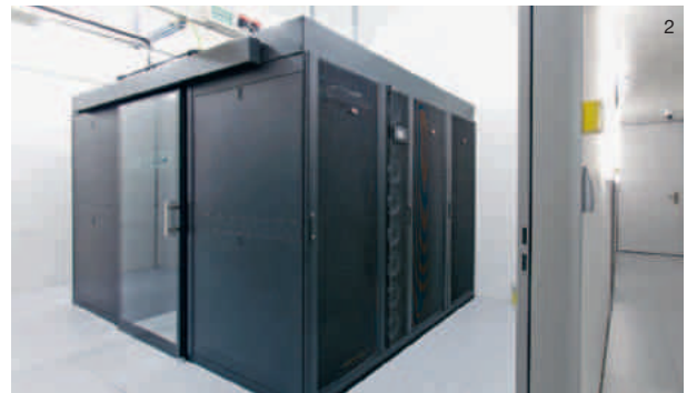
1 Eingang DataCenter LuzernZentralschweiz, Luzern. Foto: Matthias Jurt, Luzern.
